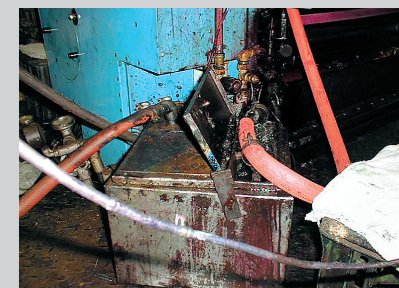
Sovraccarico di una vasca intermedia caratterizzato da scarsa manutenzione. Foto Technotrans.
