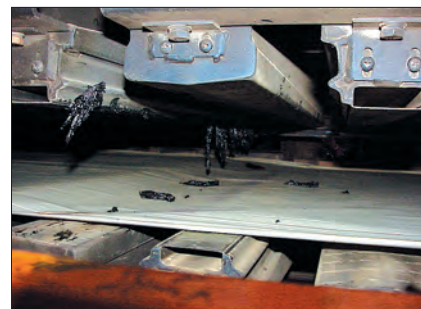
Бумажная пыль и частицы краски могут образовывать твёрдые отложения, выступающие из шлицев воздушных сопел и приводящие к отмарыванию и обрывам бумажного полотна.
