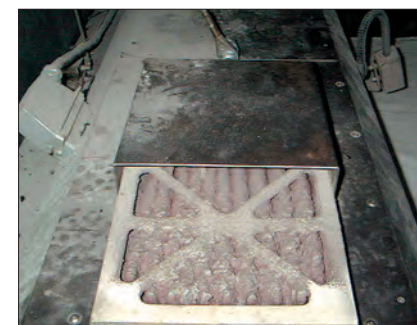
Пыль засасывается в электрошкаф печатной машины и оседает в фильтре. Если фильтр не очищается, электрические узлы могут перегреться, выйти из строя и вызвать пожар Фотография MEGTEC
