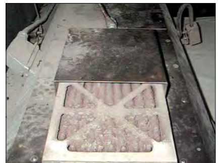
印刷机周围的灰尘被吸入配电箱，并沉积在过滤器上。如果不清洗过滤器，会造成电气部件过热，并造成损坏。甚至会发生火灾。 照片：MEGTEC公司
